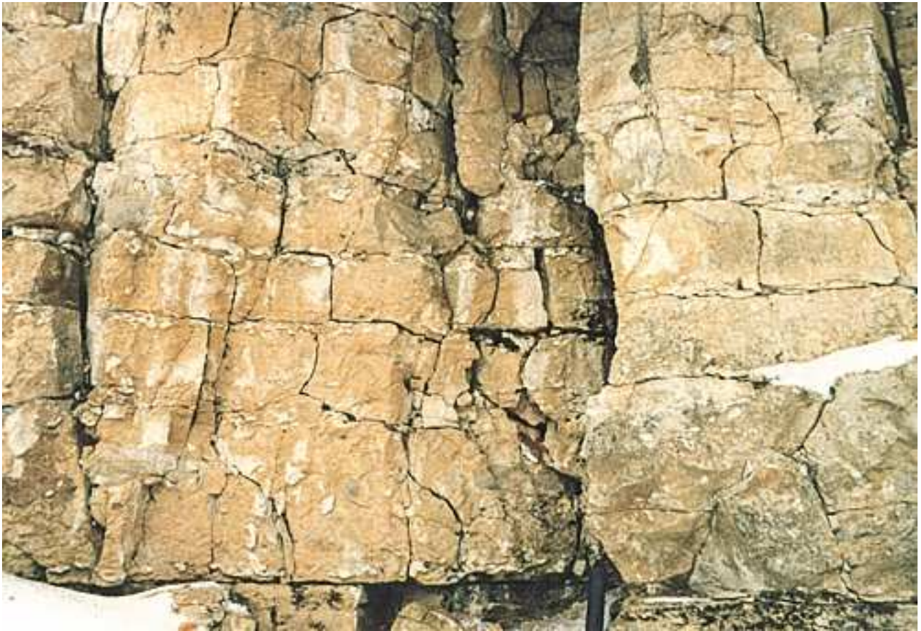
Abb. 53: Liegende Bankkalke des Weißen Jura \zeta 1 mit herauswitternden Kieselknollen (Aufgelassener Steinbruch N Gnanenweiler, Nr. 6).
