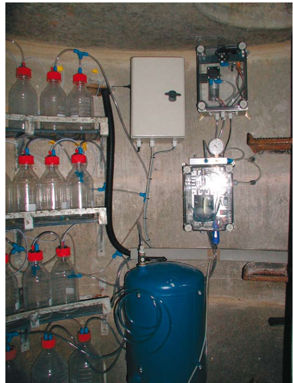
Unterdruckvorrat (blau) und Unterdrucksteuerung der Plattenlysimeter Messstelle Forst sowie Saugflaschen bei Schachtlösung
