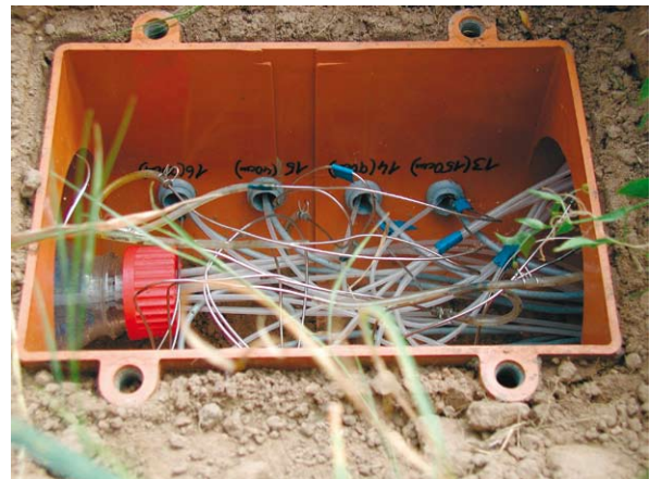
Revisionschacht zum Befüllen unterirdisch verlegter Tensiometer
